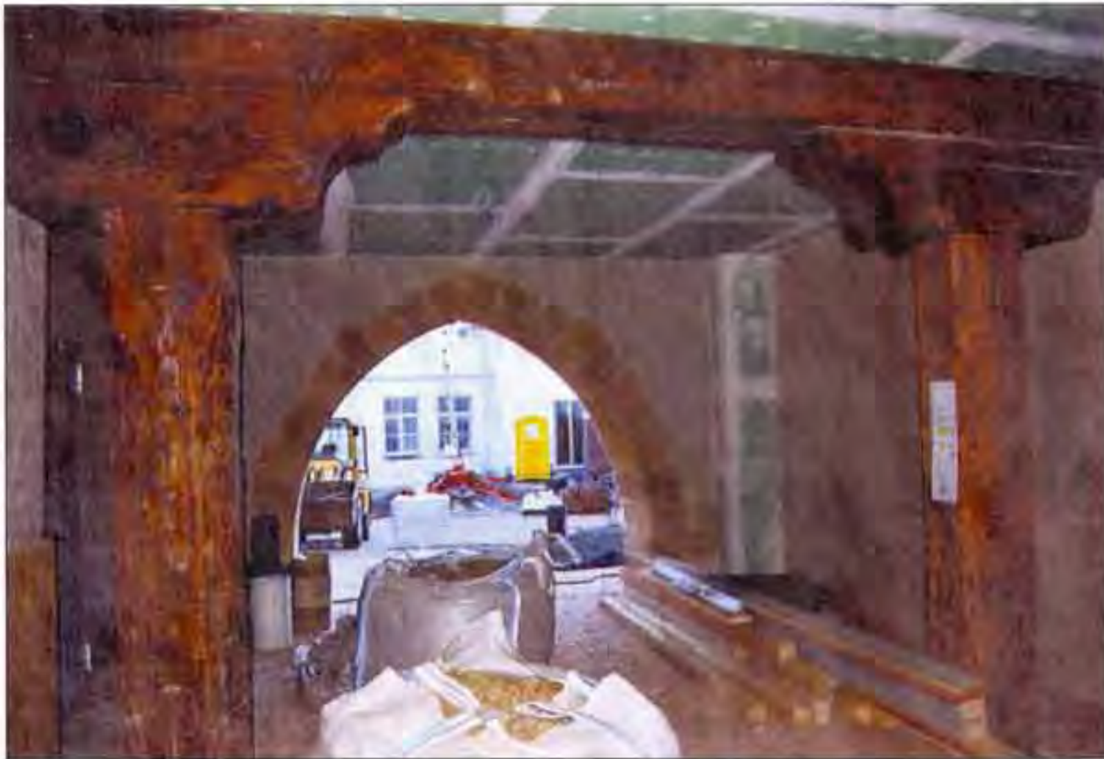
Die Stützbalken im großen steinernen Haus, dessen Bauzeit auf das Jahr 1472 zurückgeht.
